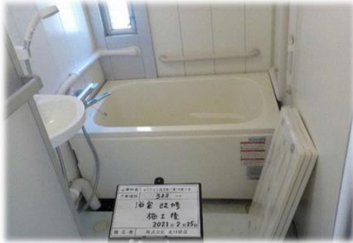
市営住宅におけるバリアフリー化改修工事 (浴室における転倒防止の手すり設置等)
