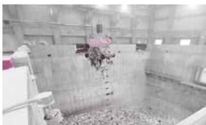
ごみピット・ごみクレーン
