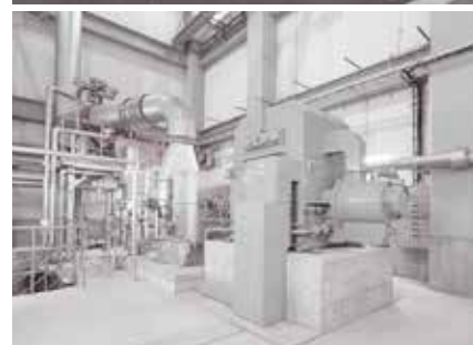
蒸気タービン発電機
