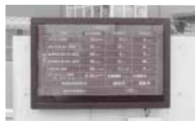
公害監視モニタ(排ガス濃度を表示)
