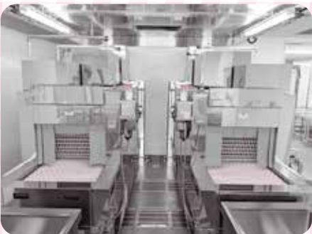
洗浄室 食器、食缶、コンテナなどを洗浄します。
