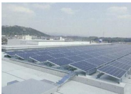
太陽光発電(甲賀市)
