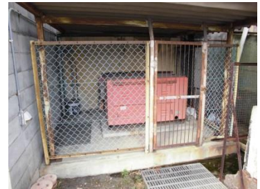
不十分な自家発電設備
