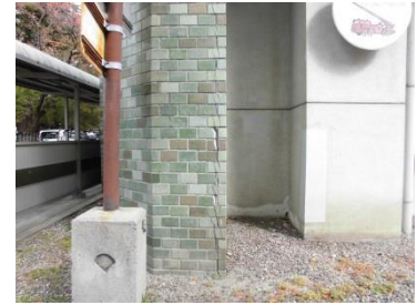
外壁タイルのひび割れ
