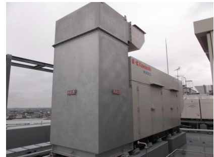
自家発電設備（愛知県刈谷市）
