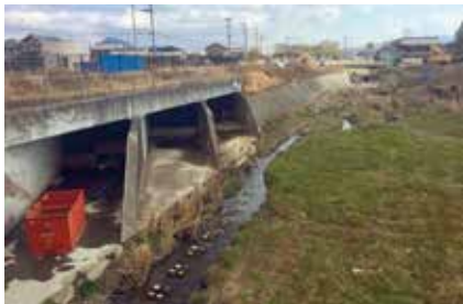
▲雨水幹線放流渠(三宅町)
