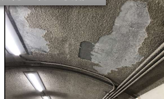
吹付け材の剥離
