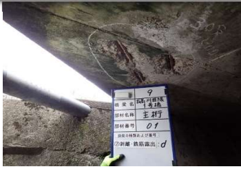
床版：鉄筋の露出・腐食
