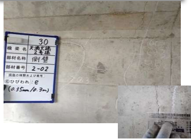
橋台・側壁：ひびわれ
