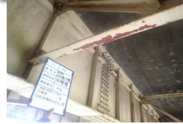
鋼部材：防食性能の劣化
