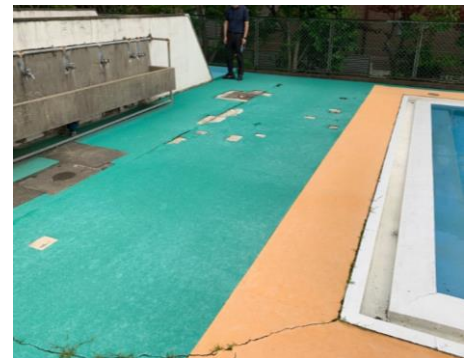
プールサイド床材の劣化(吉身小)
