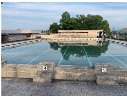
施設全体が老朽(守山北中)
