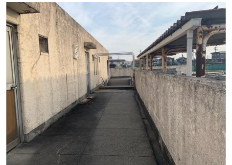
施設全体が老朽(守山北中)
