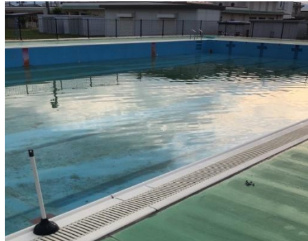
プール槽の劣化により水位が低下(小津小)
