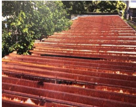
プール棟屋根の腐食(小津小)
