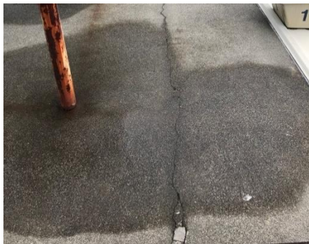
プールサイド床材の劣化(物部小)
