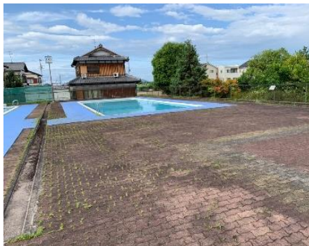
プールサイド床材の劣化(河西小)
