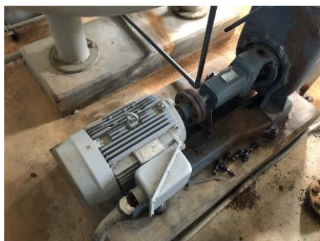
ろ過ポンプの老朽化による故障(全校的)
