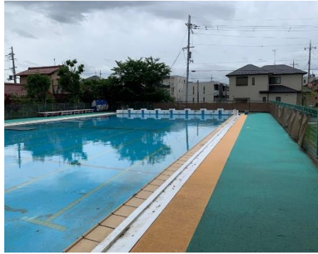
プール槽の劣化(吉身小)
