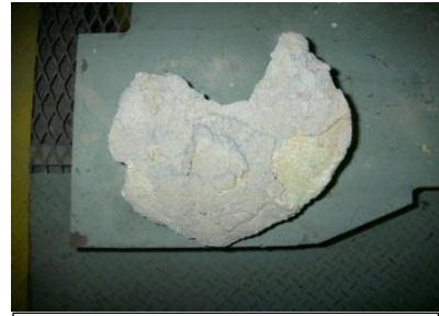
落下した耐火物
