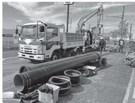
下水道管破損事故 緊急対応
