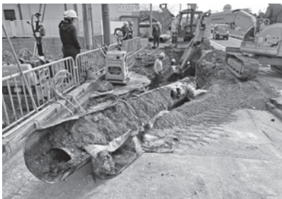
下水道管破損事故の状況
