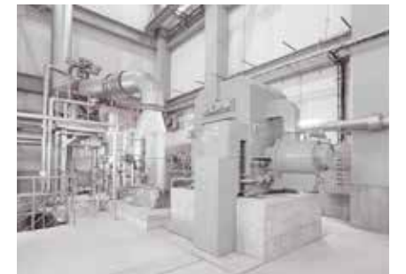
蒸気タービン発電機
