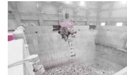
ごみピット・ごみクレーン
