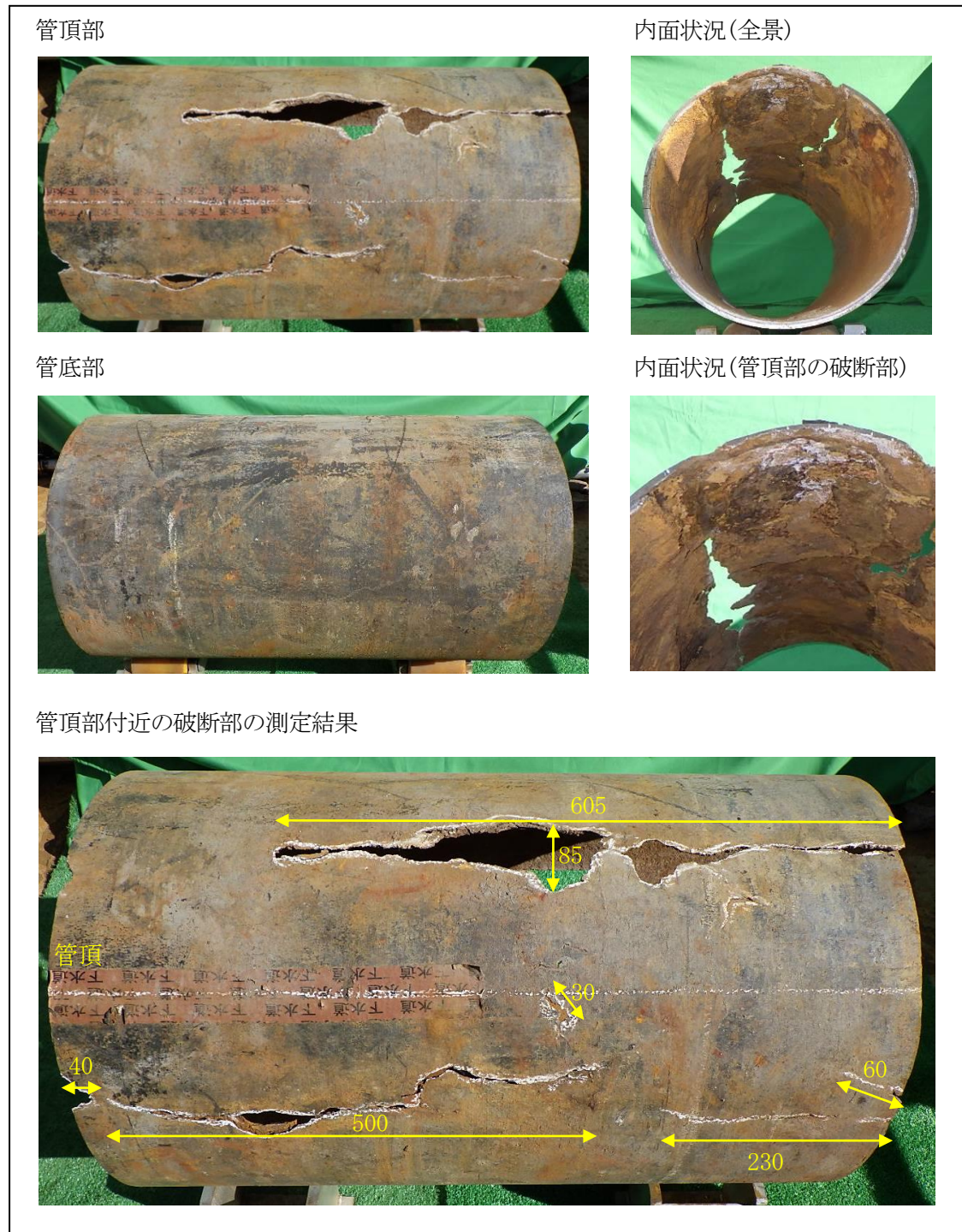
写真2 搬入時の外観状況及び管頂部付近の破損部状況
