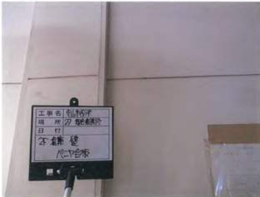
守山市役所新庁舎 基本設計業務における 石綿事前調査
