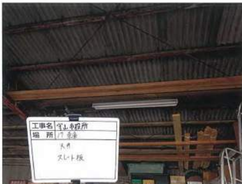
守山市役所新庁舎 基本設計業務における 石綿事前調査
