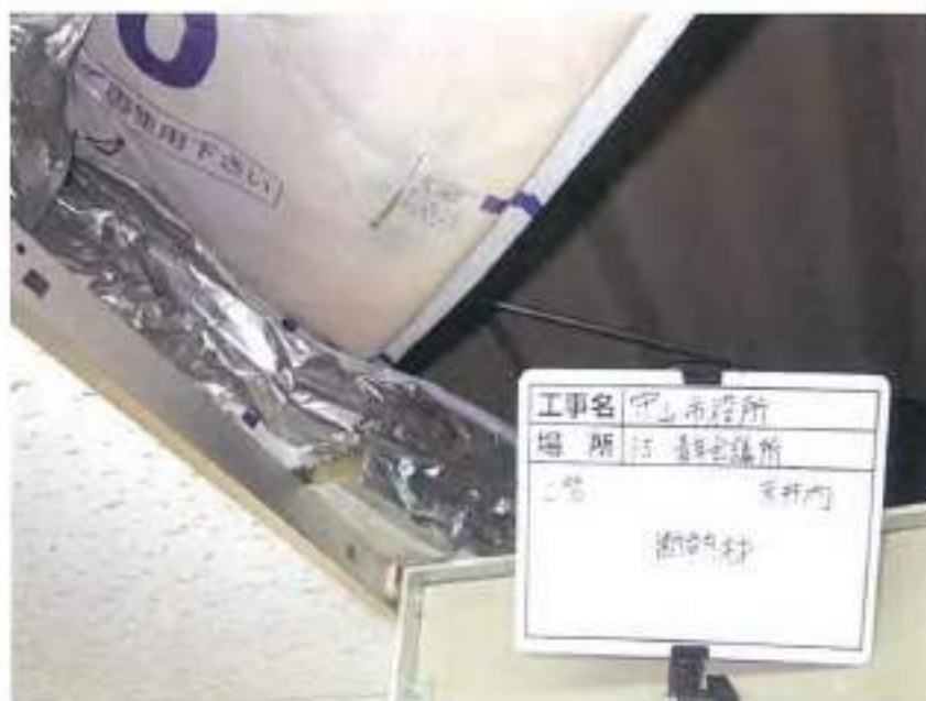
守山市役所新庁舎 基本設計業務における 石綿事前調査
