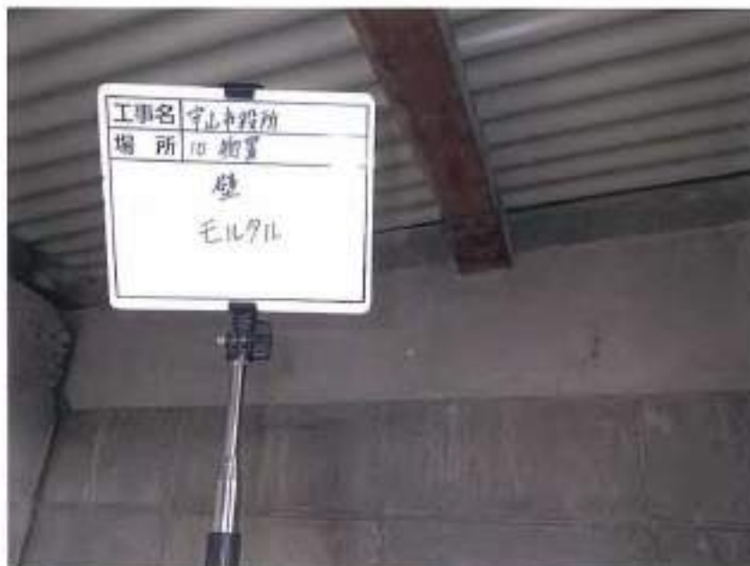
守山市役所新庁舎 基本設計業務における 石綿事前調査
