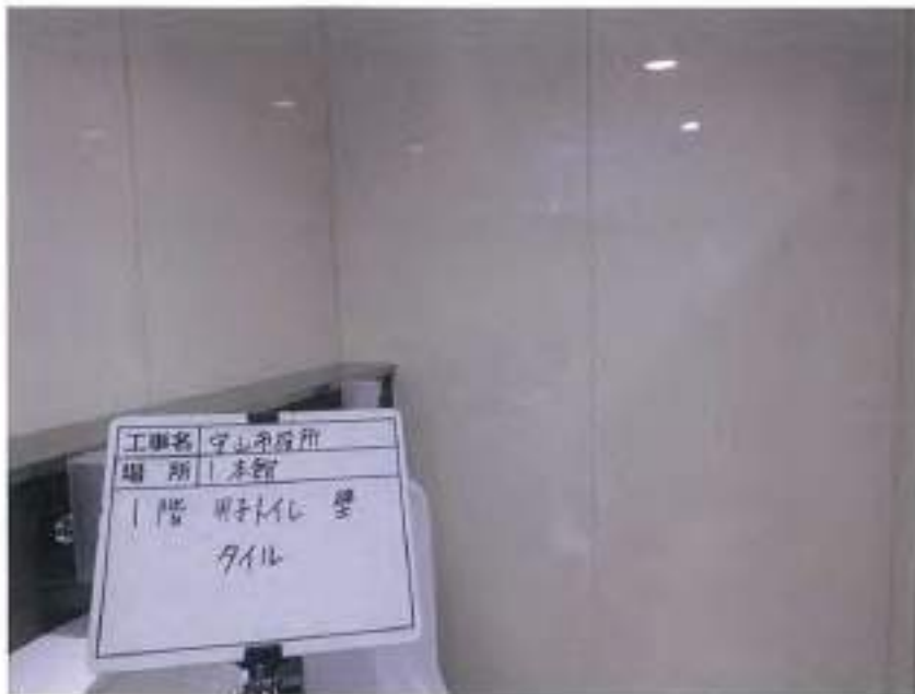
守山市役所新庁舎 基本設計業務における 石綿事前調査
