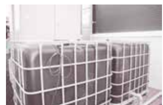
雨水を再利用するためのタンク利用
