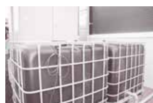
雨水を再利用する ためのタンク利用
