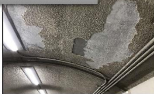
吹付け材の剥離
