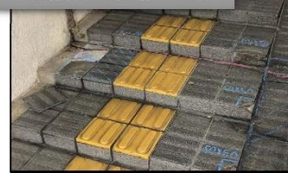
タイル舗装の欠損・うき
