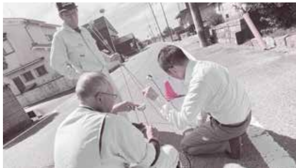
音響AI×衛星データによる次世代型漏水検知で スマートインフラ管理〔Hmcomm株〕
