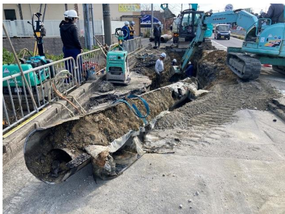
今市町地先における汚水管渠破損事故
