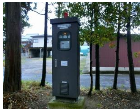
荒見第2中継ポンプ場
