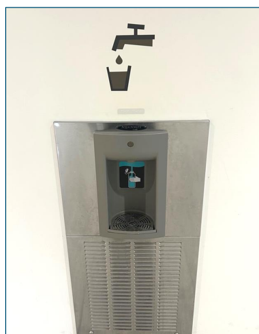
・庁舎 1 階のウォーターサーバー
